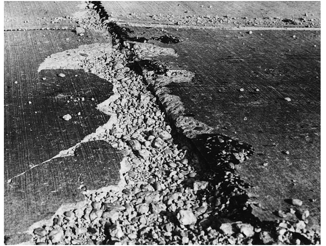
Fig. A.2.16a—Joint spall
